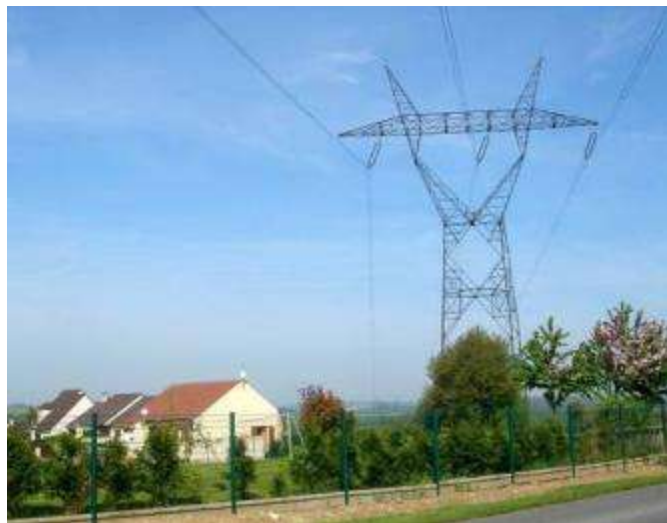
La ligne à Haute Tension
